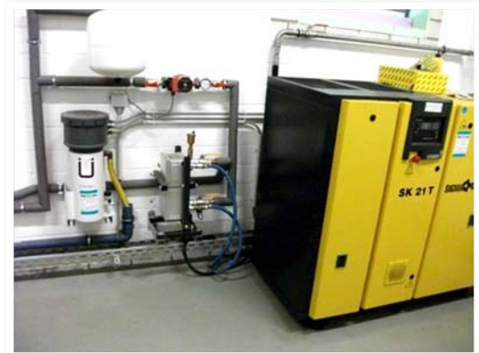
Wärmerückgewinnung von einem Schraubenkompressor, täglich 75kWh
