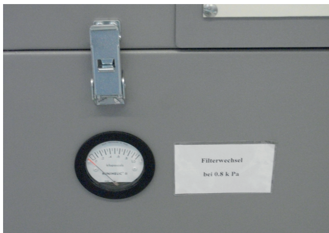
Bild 3: Ein stromloses Differenzdruck-Manometer zeigt den Zustand des Partikelfilters an
